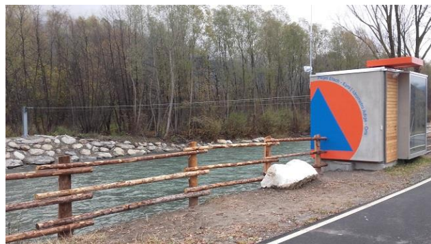
Figure 1. e 2. Cantiere per la costruzione della nuova stazione idrometrica di Oris (a sinistra) e opera completata (a destra).
